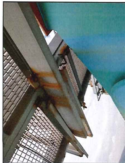
Local: Apex Item # 60: pontos de corrosão nas passarelas de acesso ao Apex.
