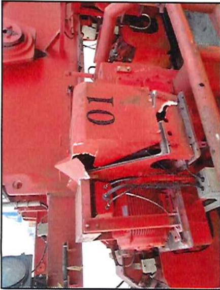
Local: Gantry Item # 02: avaria na tampa de proteção do Gantry 01. (corrigido)
