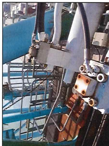
Local: Plataforma do TLS Item # 38: pontos de corrosão nos cilindros hidráulicos, tubulações e válvulas, no TLS.
