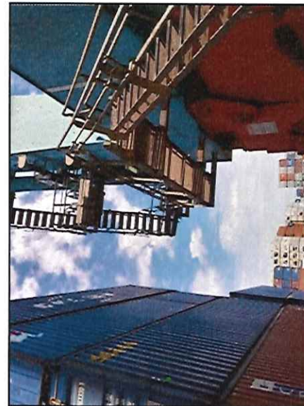
Local: Gantry Item # 09: avaria na escada de acesso ao guindaste.
