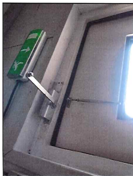
Local: Sala Elétrica Item # 31: molas da porta da sala do CMS estão soltas.
