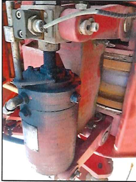
Local: Gantry Item # 02: pequeno vazamento de óleo em um dos cilindros de freio das rodas do Gantry.
