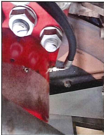
Local: Sala de Máquinas Item # 22: pequeno vazamento de óleo hidráulico nos atuadores de freio do Hoist.
