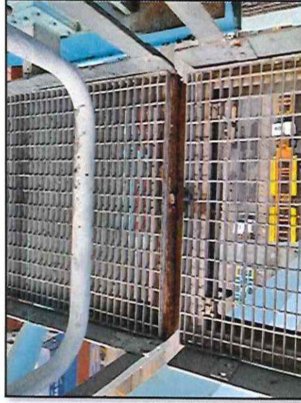
Local: Lança Item # 50: pontos de corrosão nas passarelas da lança.
