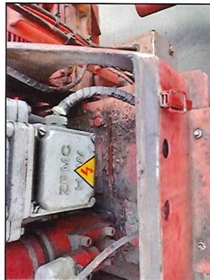
Local: Gantry Item # 05: pontos de corrosão na base dos freios do Gantry.
