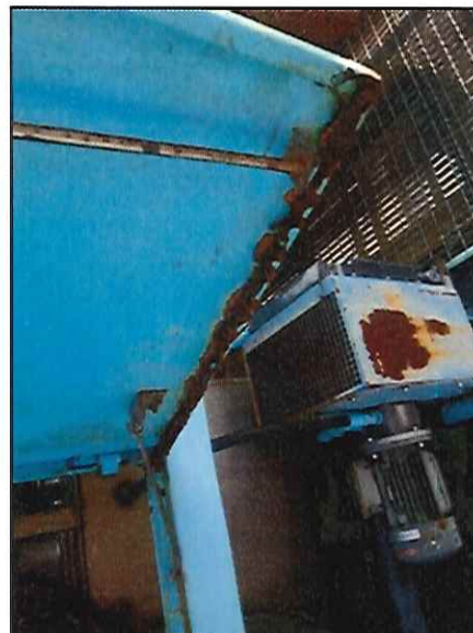
Local: Plataforma do TLS Item # 40: pontos com corrosão no painel da unidade hidráulica do TLS.
