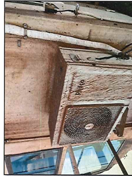
Local: Cabine Item # 61: Excesso de sujeira na cabine do operador e nos corrimões de acesso à cabine. (corrigido)
