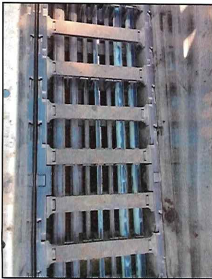
Local: Trolley Item # 41: Ligeiro desgaste nas capas de proteção dos cabos elétricos que passam pela esteira cable-track.
