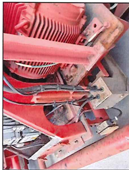
Local: Gantry Item # 05: pontos de corrosão na base dos freios do Gantry.
